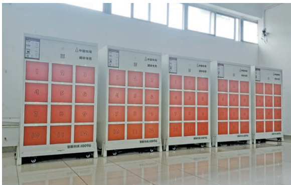
运营场地充电区域充电柜
